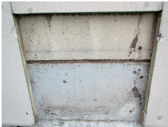
図6 西面外断熱材撤去後の状況(建築物A)．撤去後表面が全体的に湿っていた．
