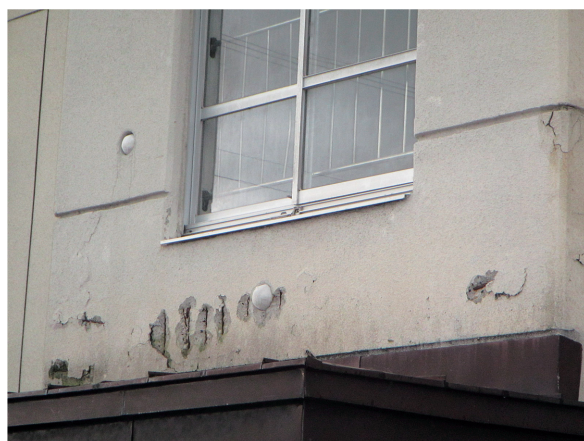
図5 階段室外壁の変状(建築物A)
