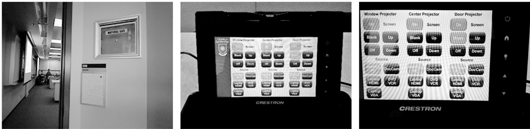
図表1 2017年度教室入口と教卓上のコントロールパネル
