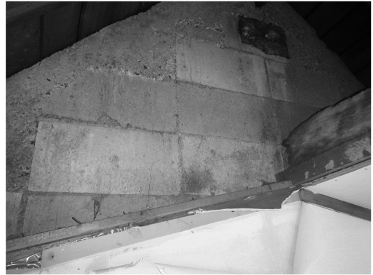
写真7 中2階妻壁の状況
