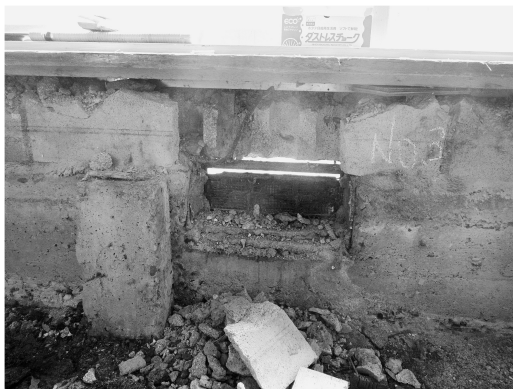
写真 5 換気口上部に露出する鉄筋 (S2)
