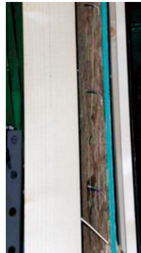
(b) V450：構造用面材の釘の頭抜け・引き抜けが発生し構造用面材が面外へ変形・移動
