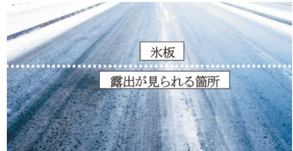
写真-6 氷板路面の路面露出状況
